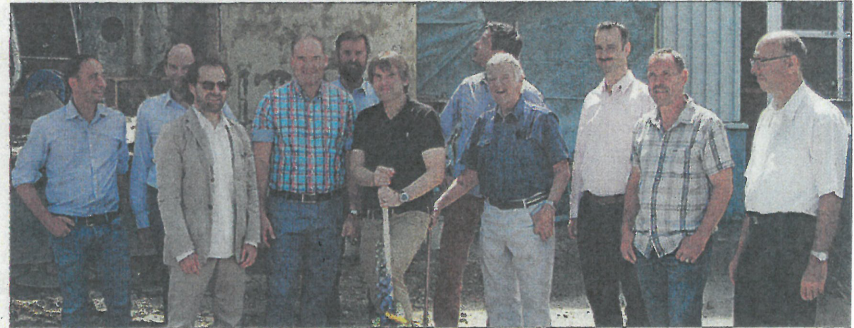
Bauherrschaft, Planer, beteiligte Unternehmer und Mitarbeitende der Firma Tschopp Holzindustrie AG Buttisholz beim offiziellen Spatenstich für das 60 Meter Pellet-Silo. Foto Willi Rölli
